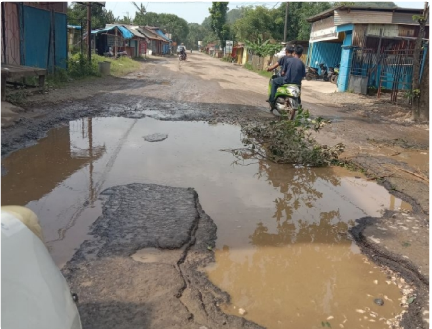
Jalan Minasate'ne rusak parah
